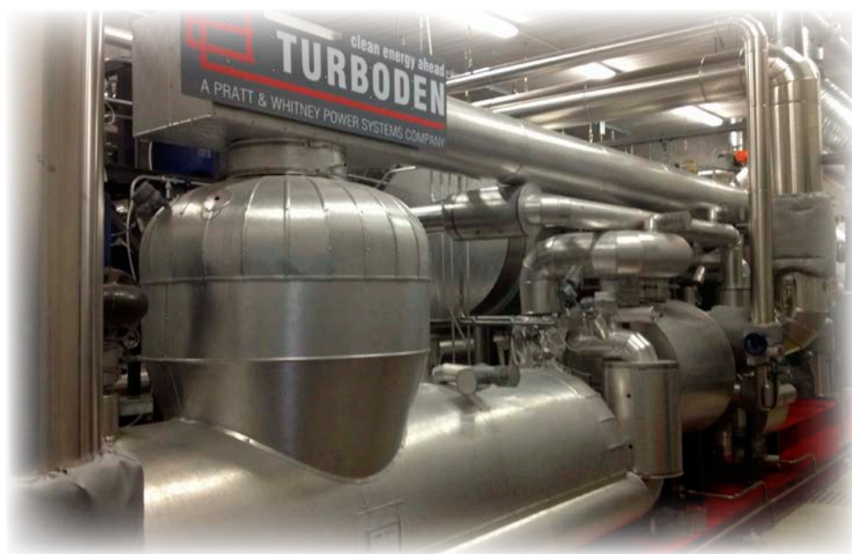
ORC maskinen på Marstal fjernvarme.
